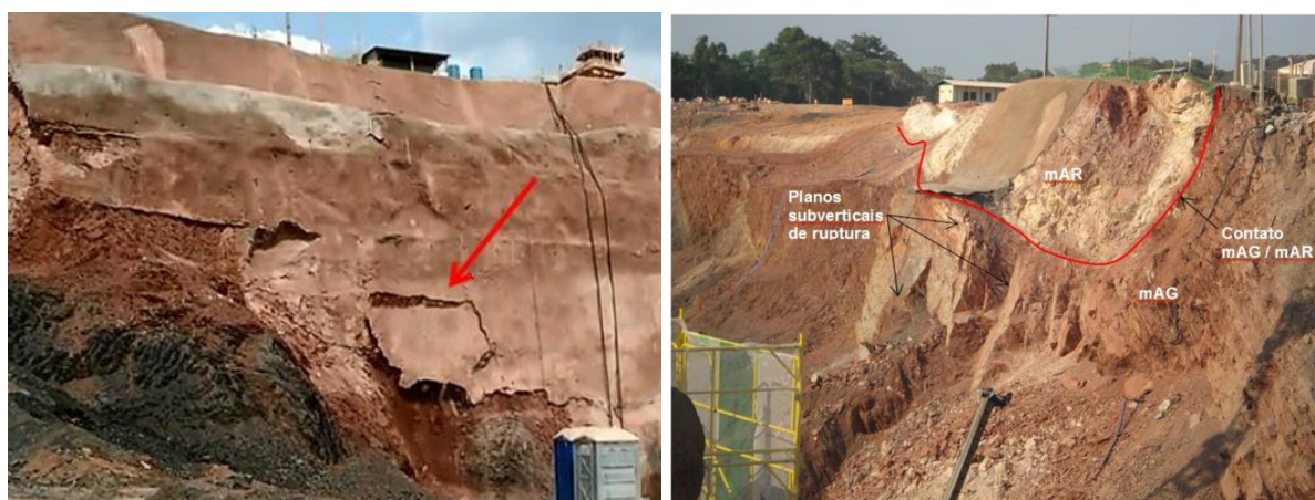
FIGURA 1 – Início do processo de ruptura e situação final da área afetada.
